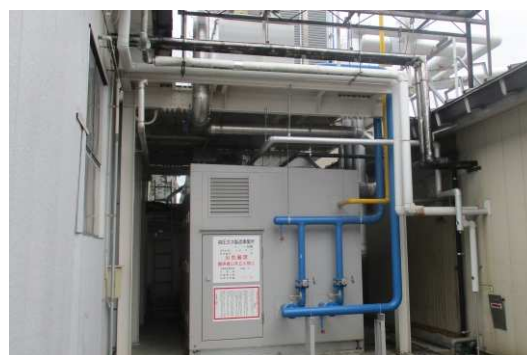
本楯工場 自然冷媒冷凍機
