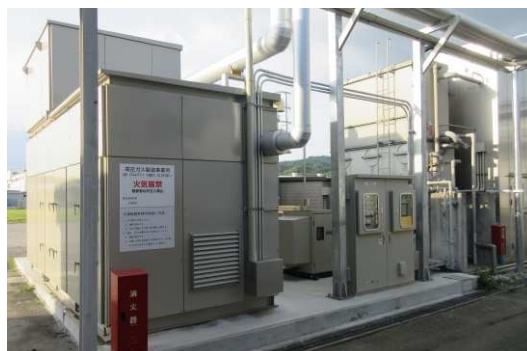
九州ベストフーズ 自然冷媒冷凍機
