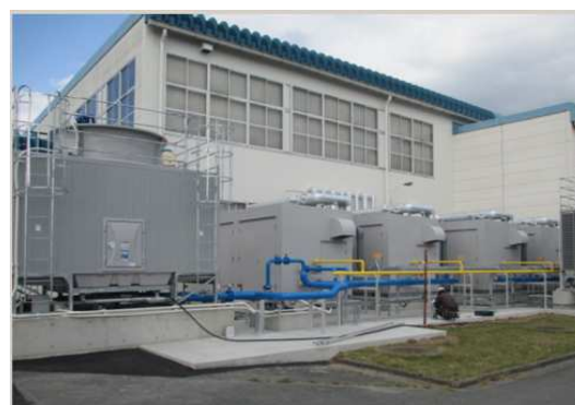
山形工場 自然冷媒冷凍機
